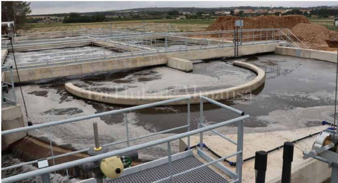
estanque de carrusel depuradora
